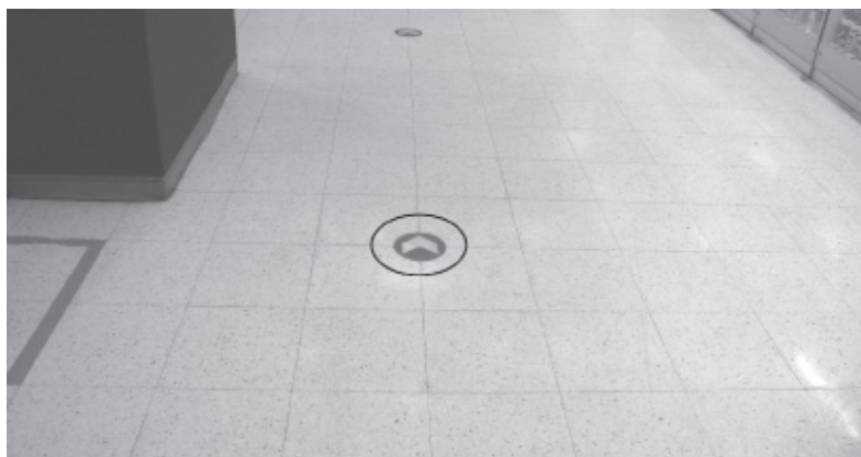
图2 商场中地面安全疏散标志
